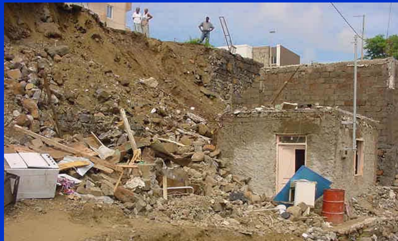
Soterramento de parte de uma casa - T. Branca
