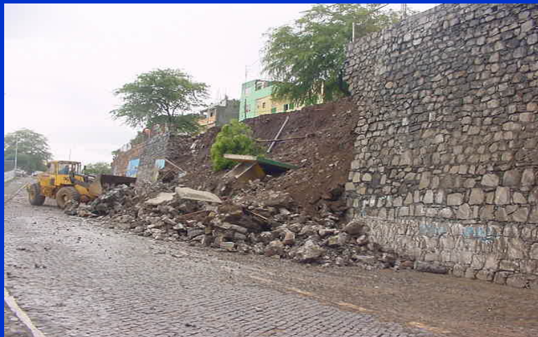
Derrocada de um muro A.S.A. - 3 Set. 2006
