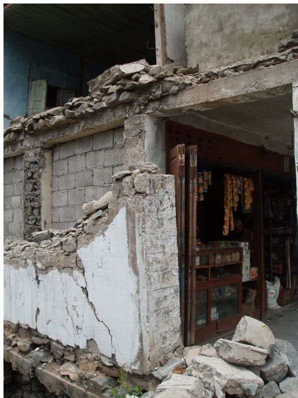
Фото № 5. Центр жилого квартала. Обвалившиеся стены были построены из кирпича и камня вперемешку с цементом и известкой. Остальные несущие стены не пострадали. Слегка наклонная местность. 10-30 лет.
