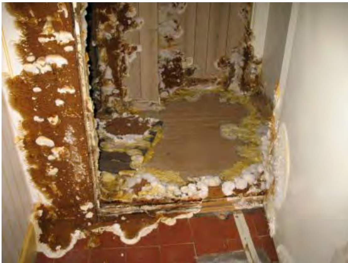
SOPP. Et angrep av ekte hussopp kan gi store skader (Foto: Johan Mattsson)
