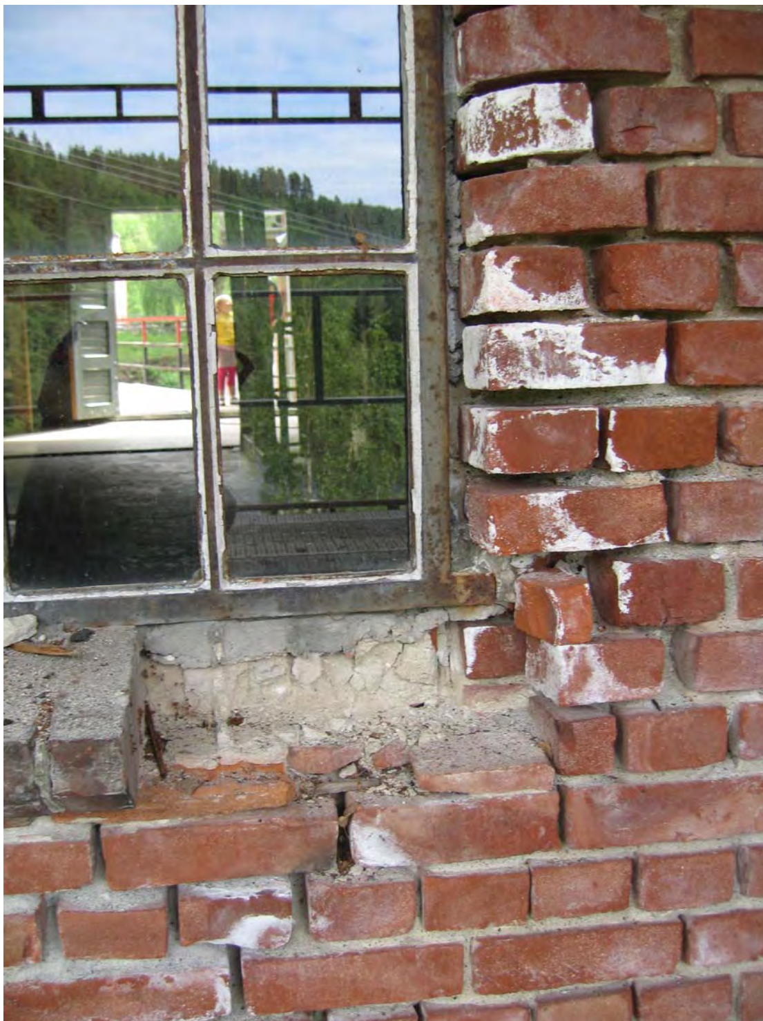
SALTKRYSTALLISERING. Saltkrystallisering i teglsteinsmurverk (Foto: Anne-Cathrine Flyen)
