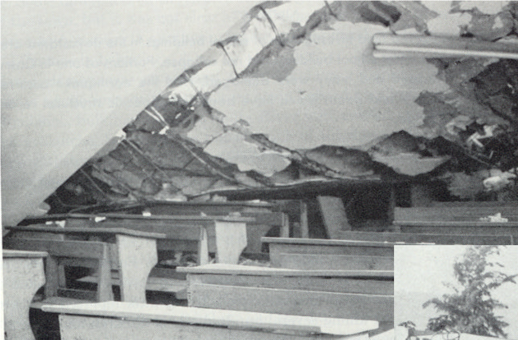
Techo caído sobre carpetas
