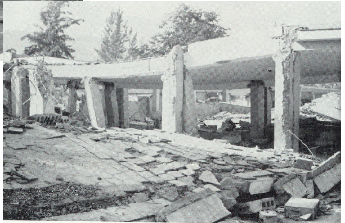
Techo totalmente desplomado
