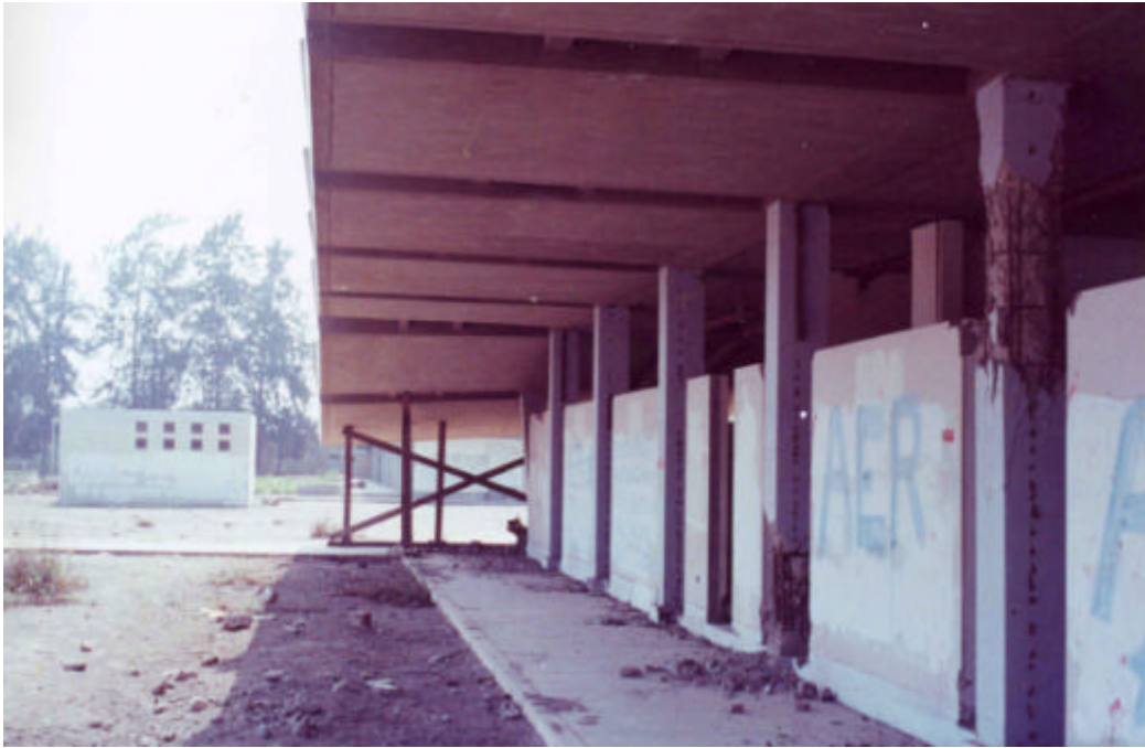
Fallas en Columnas (La Molina)
