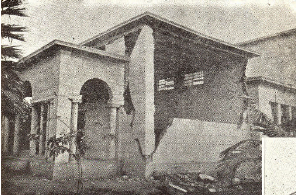
Desplome de Muros (La Molina)
