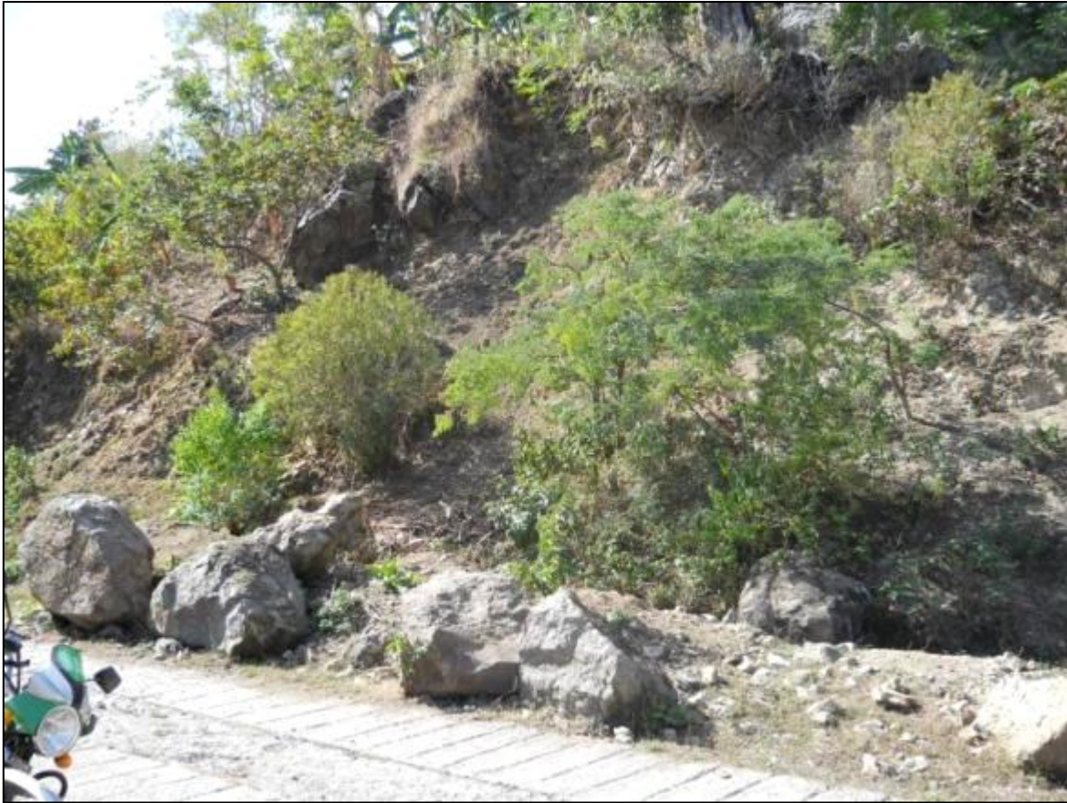
Fig. 32 Éboulements dans la route pour aller à Value (Petit Goâve).
