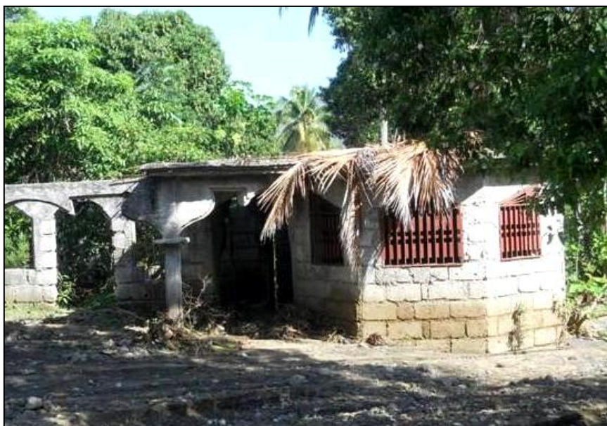
Fig. 26: Traces de passage de l'eau dans le mur (zone de Violet).
