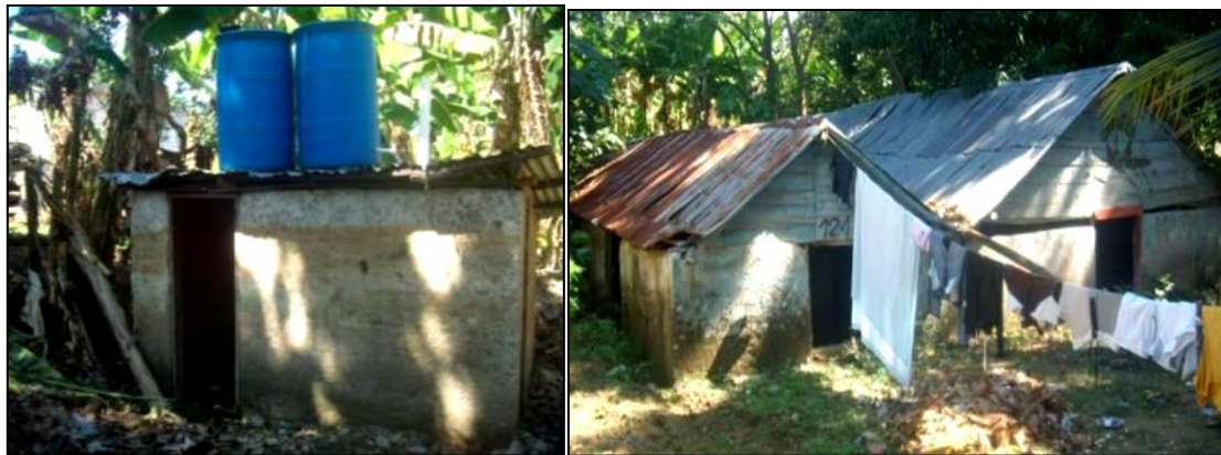
Fig. 35 Les traces d'eaux laissées pendant les pluies.
