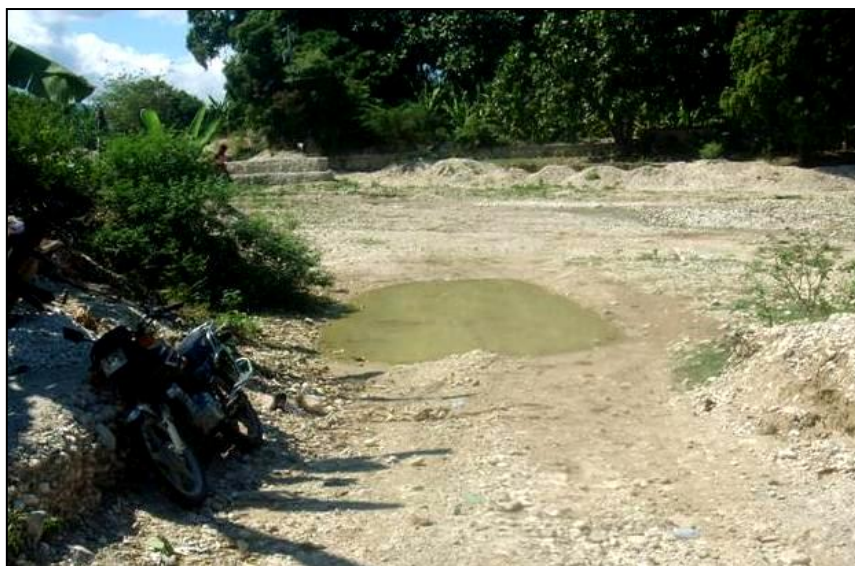
Fig. 36 Photo de l'érosion de berges dans la rivière Lavagne,
