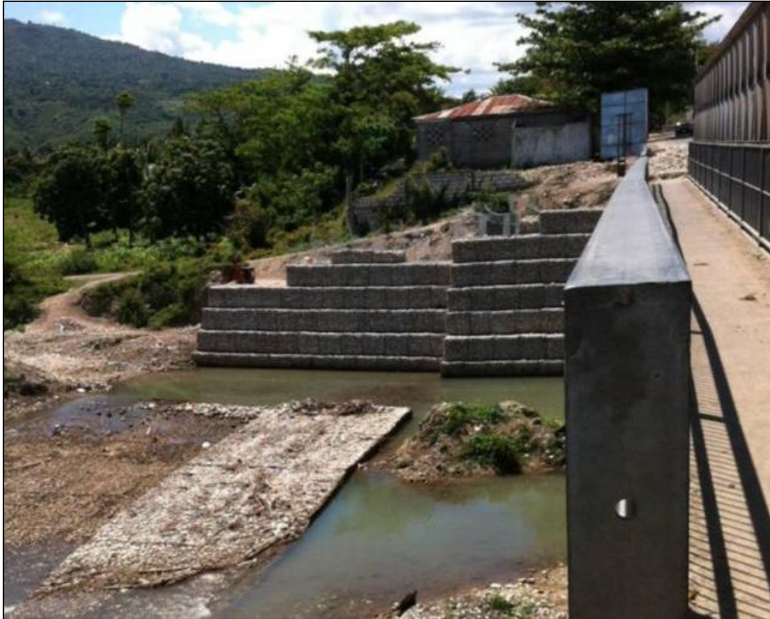
Fig. 51 Gabionnage dans la rivière La Gosseline dans la zone de Bassin Cayman
