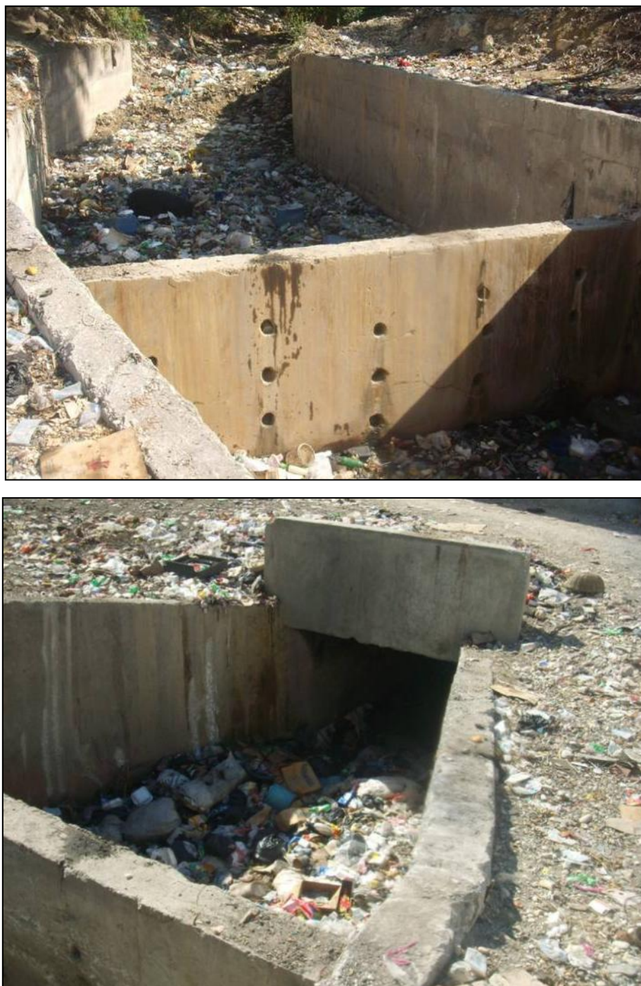
Fig. 40 Canal de drainage remplis par déchets (centre de ville de Jacmel).
