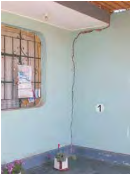
>>Fig 5.1 Se observa que, en el techo, el voladizo no continúa y no tiene columna de amarre. Se trata de una ampliación efectuada en el patio exterior de una casa ubicada en Comatrana, Ica, que fue dañada por el sismo del 15/08/2007. Ver ubicación en F-5.1.
