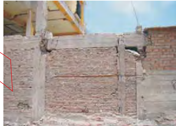
>>Fig 1.2a La foto muestra un muro confinado. Sus ángulos superiores se han estrellado contra la unión viga-columna, y la han hecho fallar; asimismo, se han deteriorado. Hotel ubicado en Pisco. Dañado el 15 de agosto de 2007.
