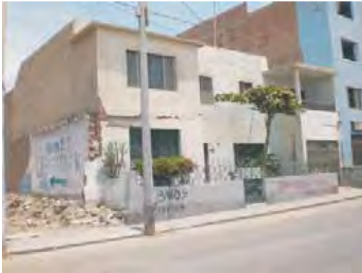
>>Fig 6.1 El edificio alto de la derecha, de cuatro pisos, hizo que fallara el segundo piso de la vivienda de la izquierda. Al ser empujada hacia la izquierda, la casa falló por corte en la unión del segundo piso con el techo del primer piso. Lugar: Pisco, ubicación F-5.2.
