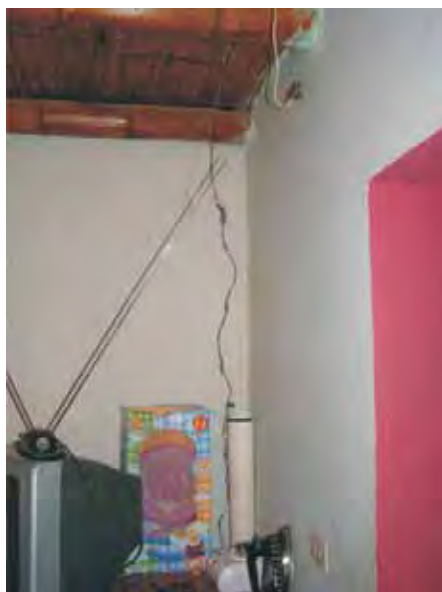
>> Fig 3.1 Grieta por flexión negativa cercana a la esquina, que se propagó de arriba hacia abajo. Lugar: Comatrana, Ica.
