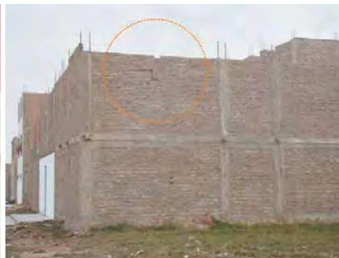
>> Fig 3.3 Cuando las columnas están separadas más de 5.5 m, la falla, se produce generalmente, en la parte superior media del muro, por momento positivo. Explicación en F-3.4 . Lugar: Pisco. Ubicación en F-5.2b .
