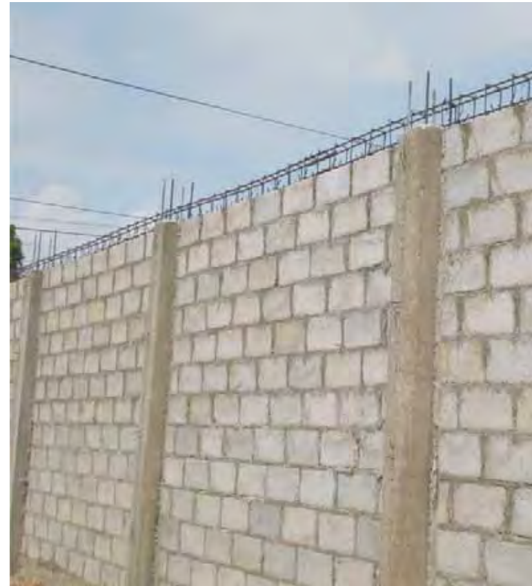
>>Fig 7.8 Cerco de un colegio con armadura de viga collar muy angosta. Solución: Desatar los fierros de la viga de amarre y colocar nuevos estribos para que el ancho de la viga collar sea el mismo que el ancho de la columna. Encofrar el fondo de la viga collar y los costados con el mismo ancho que la columna y, luego, llenar con concreto.
