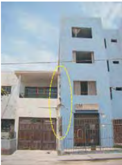
>>Fig 6.2 Detalle de la zona de impacto entre las edificaciones de la F-6.1.
