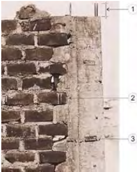
>>Fig 7.7 Columna de confinamiento de cerco con defectos constructivos comunes:
