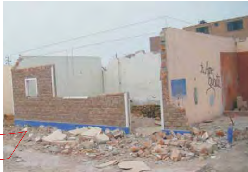
>>Fig 2a Construcciones de albañilería no confinada, sin columnas ni vigas de amarre y techo ligero. La parte superior de los muros colapsó en esta edificación, ubicada en Pisco, el 15 de agosto de 2007. Se puede notar que en la solución recomendada se trata de aprovechar al máximo los elementos que no han sufrido daños: cimentación, pisos y muros. El objetivo es reducir los costos de rehabilitación, pero proporcionando seguridad física.
