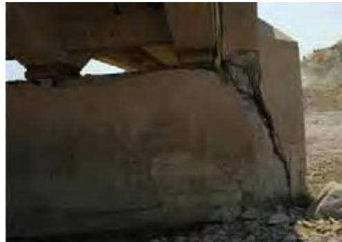
>>F-4.9 Daños en un apoyo intermedio del puente Huamaní.
