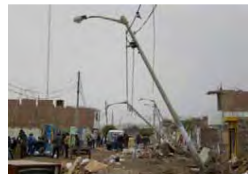
>>F-4.6 La licuación en la base de los postes eléctricos causó que estos se inclinaran.
