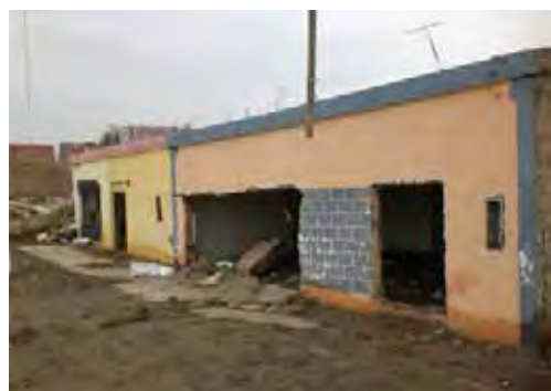
>>F-4.5 Hundimiento de numerosas viviendas entre 0.40 y 0.90 m.
