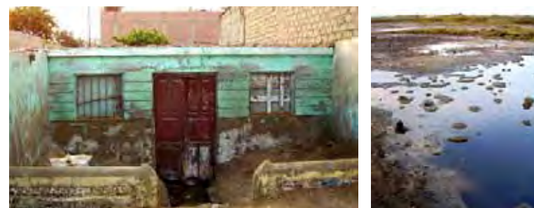
>>F-3.1a Villa María Baja, Chimbote, inundada por el desborde del río Lacramarca. Amplios sectores se mantienen fangosos por largo tiempo.
