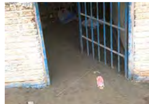
>>F-4.3 Hundimiento de varios edificios de la cárcel de Tambo de Mora.
