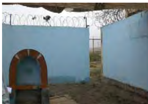
>>F-4.4 Separación de muros por corrimiento horizontal del suelo ( lateral spread ).
