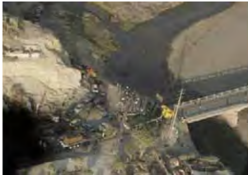
>>F-4.8 Vista área del puente Huamaní, que cruza el río Pisco. Presenta daños severos en su estribo sur y en un apoyo intermedio.
