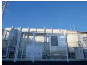
地下水膜ろ過システム
